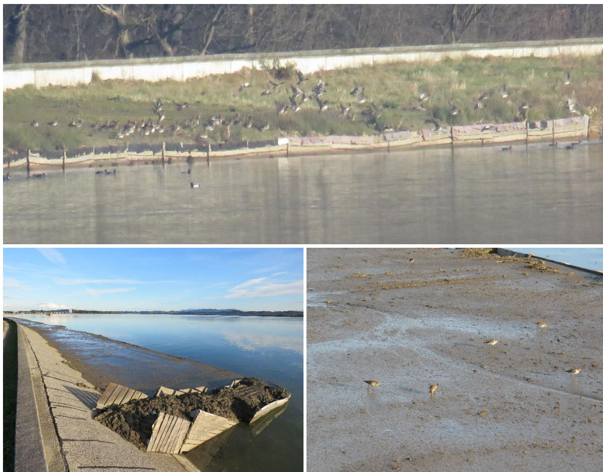
Slika 106: Dokumentarna fotografija varstveno pomembne vrste žvižgavke med prehranjevanjem v večjem številu na zgornji površini nove brežine na Območju 2 (14. 1. 2023). Levo spodaj: Blatna površina iz židkega, nekonsolidiranega sedimenta na lokaciji aktivnega prečrpavanja na Območju 2 (26. 9. 2019). Desno spodaj: Spremenljivi prodniki med prehranjevanjem na takšni površini na deponiji sedimentov nizvodno od Rance (14. 9. 2023).
